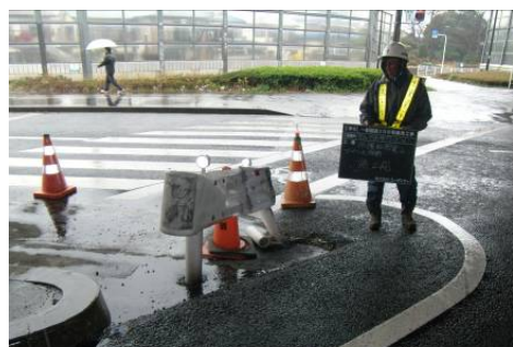
<ガードレール損傷確認>
