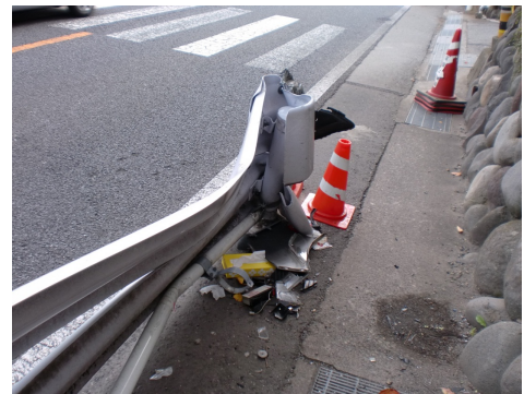
〈道路附属物損傷確認〉
