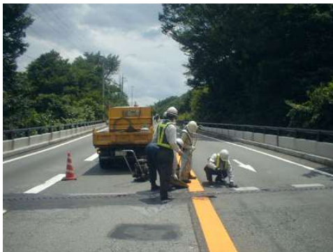
〈路面段差確認〉
