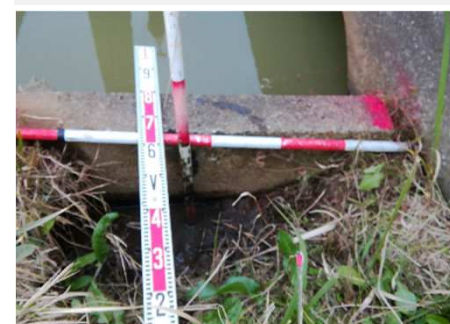
堤防点検で確認された変状 (背面の陥没)
