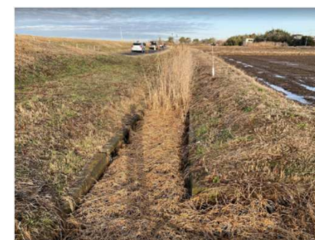
堤防点検で確認された変状 (土砂堆積)
