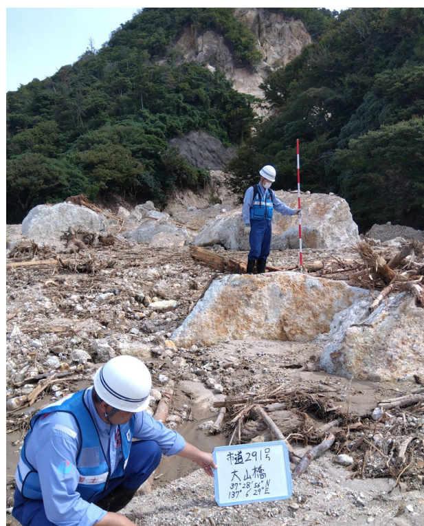
市道291号大山橋の被災状況調査【9月29日】
