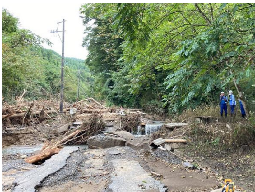
市道43号湊風呂橋の被災状況調査【9月28日】
