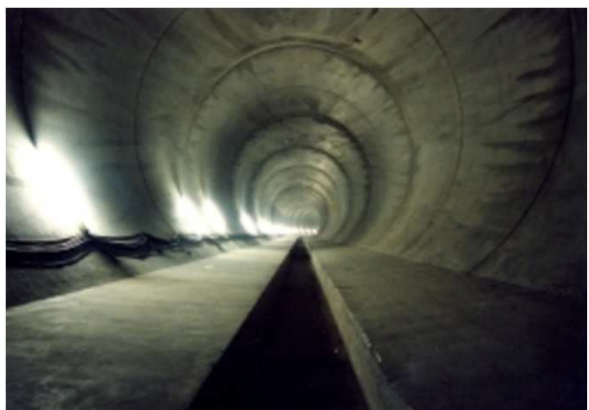
荒川雨水貯留管
