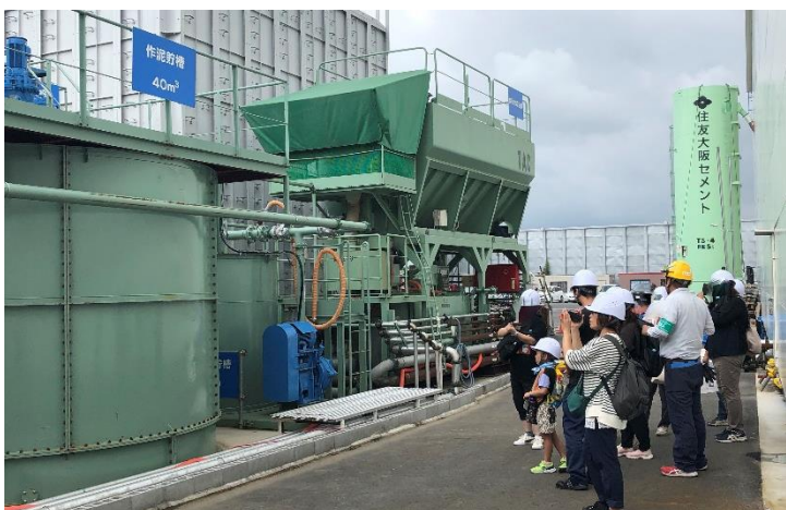
泥水処理プラント
