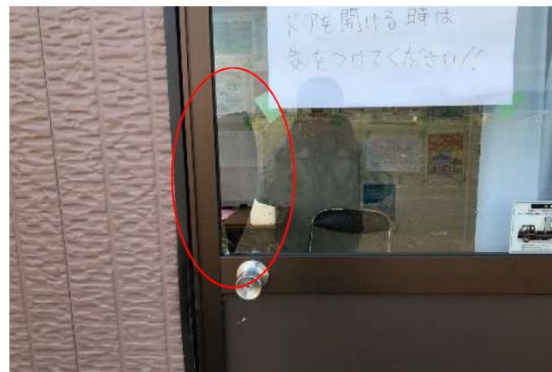
現場休憩所ガラス破壊状況
