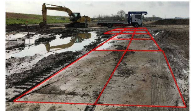
敷鉄板12枚 盗難後の状況
