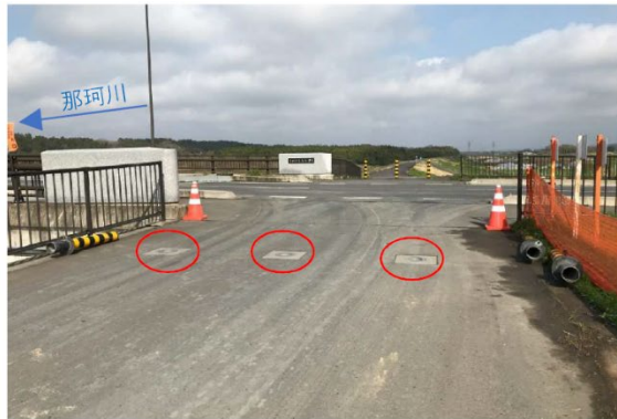
車止めポスト状況（南京錠3カ所破壊）
