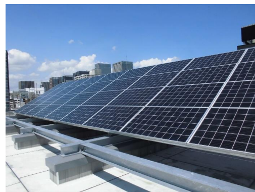
太陽光発電設備
