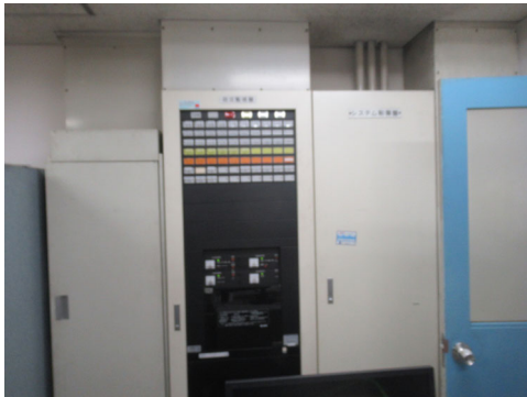
図1 事務庁舎棟（受信機）
