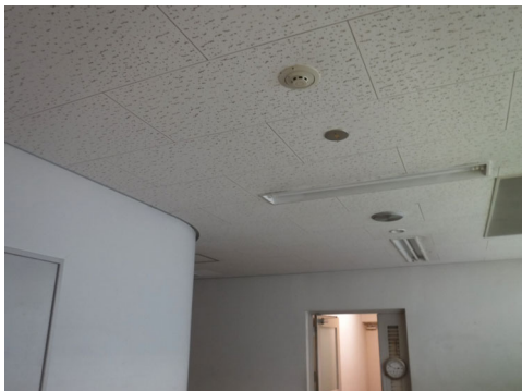
図3 事務庁舎棟（感知器）
