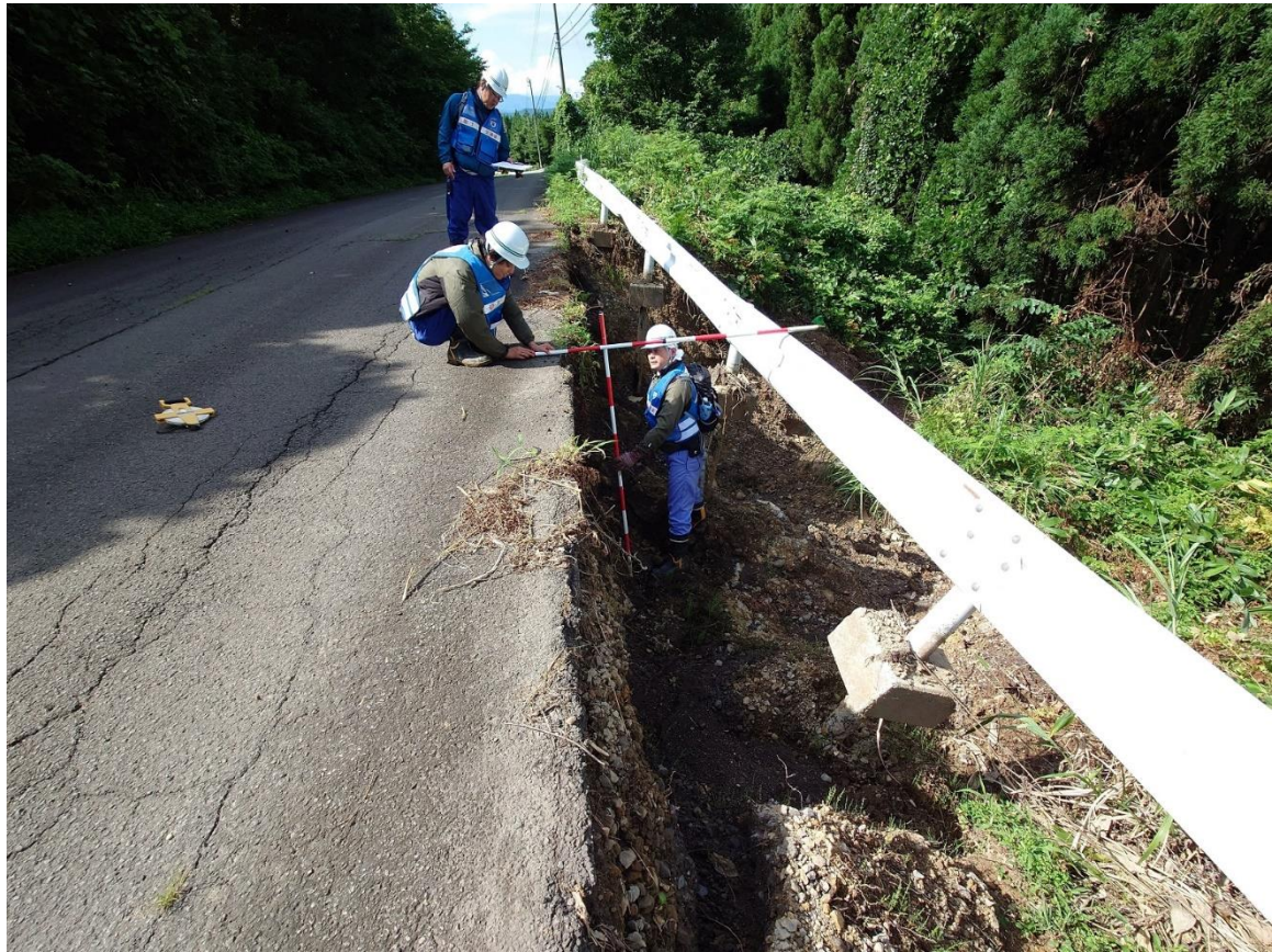
被災状況調査①
