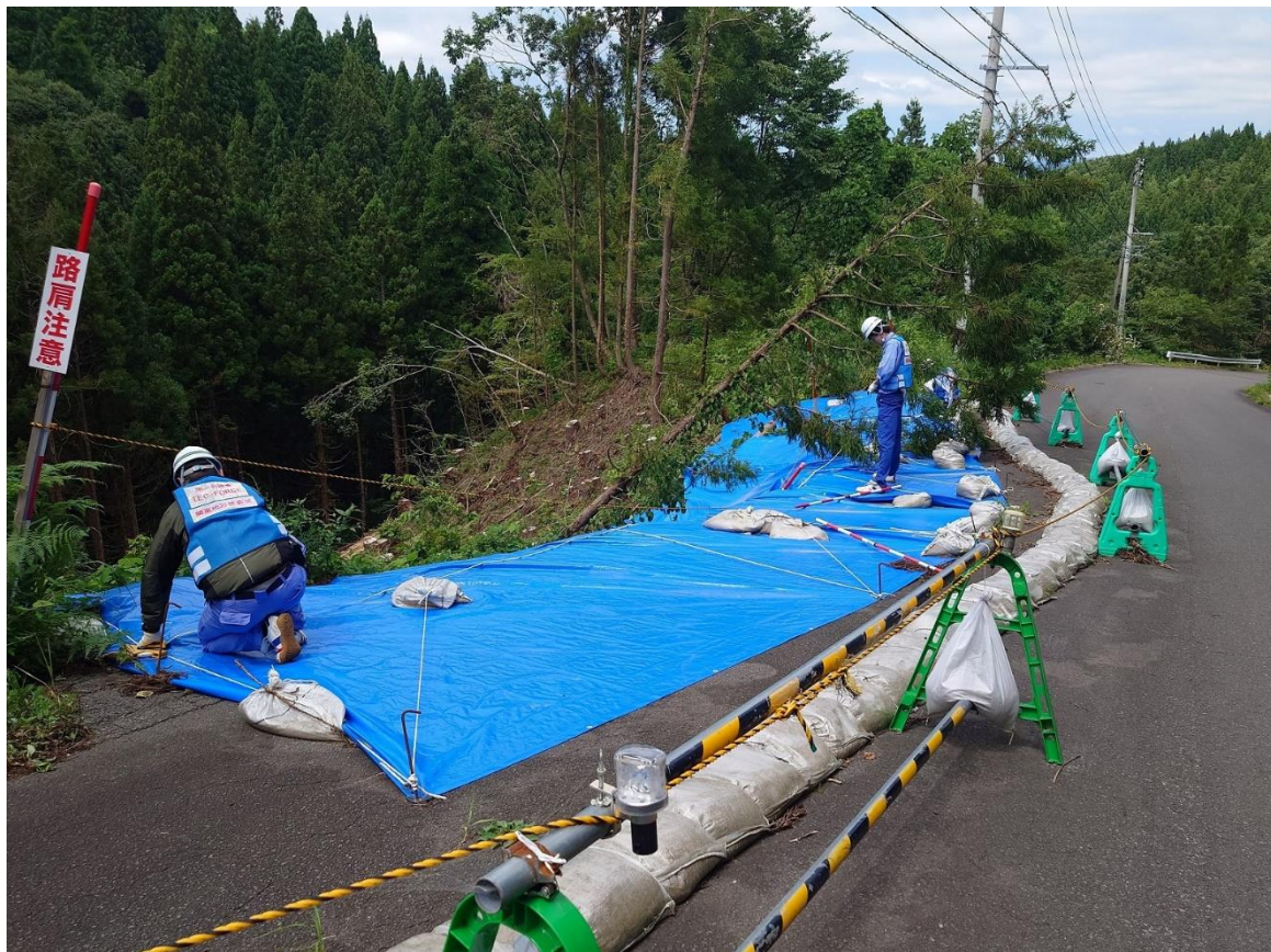
被災状況調査②
