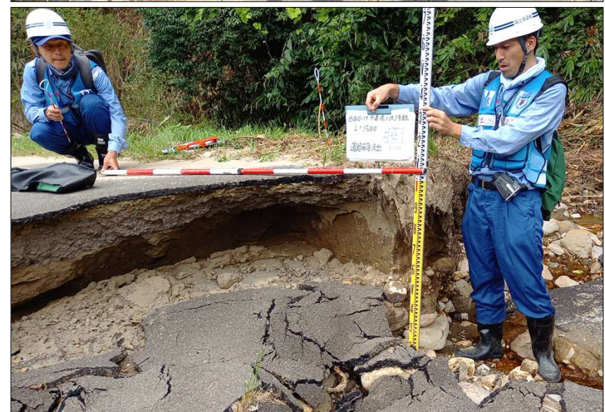
被災状況調査(秋田県由利本荘市)
