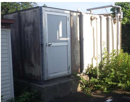
受水槽(B棟)
