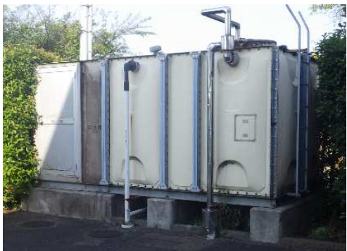
受水槽(A棟)
