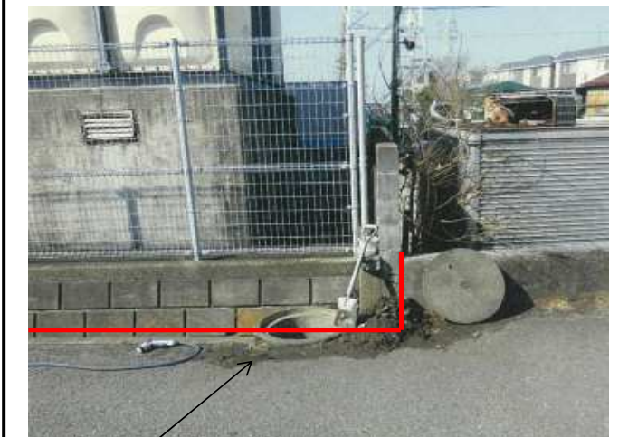
⑤排水柵部分が隣地に越境している
