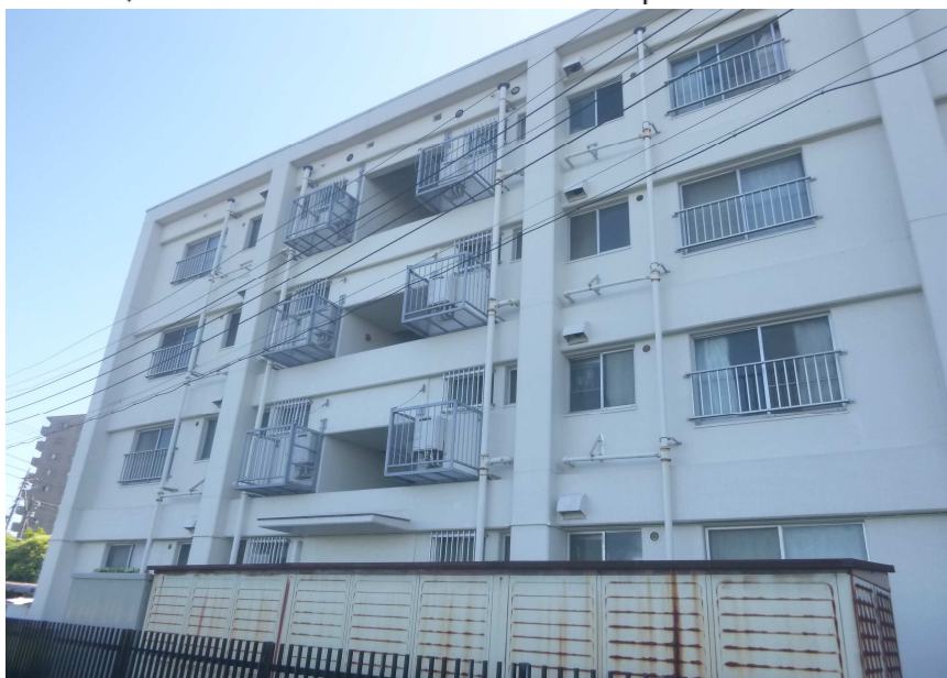
④外観(給湯設備)
