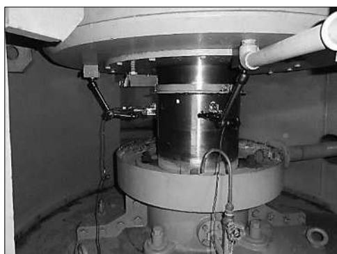
写真2 渦電流式変位計の設置（設置角90°）
