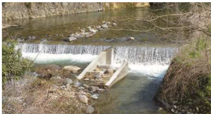
①過去に設置された魚道が破損
