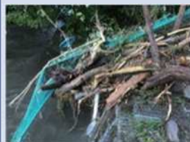
取水門の被災状況
