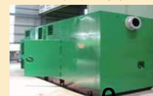
○非常用発電機
