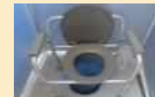
○マンホールトイレ
