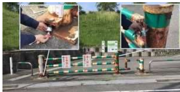
写真2 荒川下流河川事務所管内の車止めゲート
