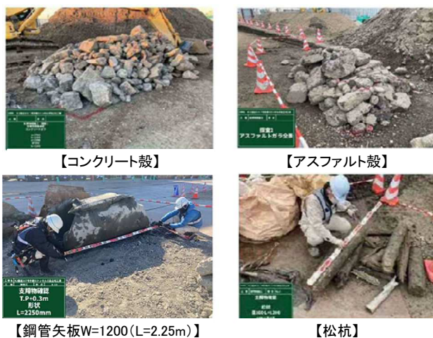
図-4 浮島立坑施工箇所を確認された地中障害物
