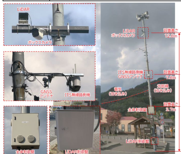
図-4 機器設置状況
