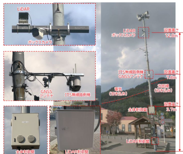
図-4 機器設置状況
