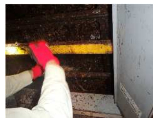
写真-3 鋼板とスクレーパ間の枝詰まりの状況
