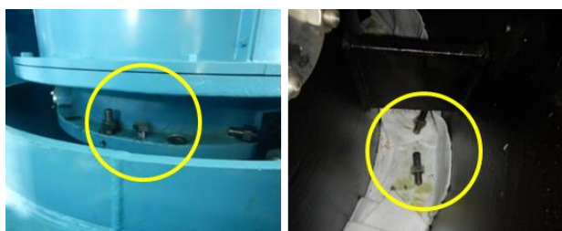
図－4 設備取付用ボルト脱落状況
