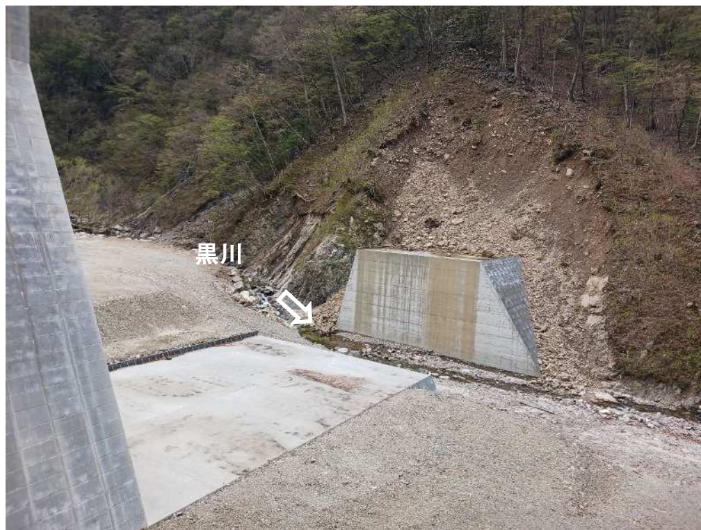
下流 右岸より本堰堤を望む（コンクリート堰堤工） （未着手）
