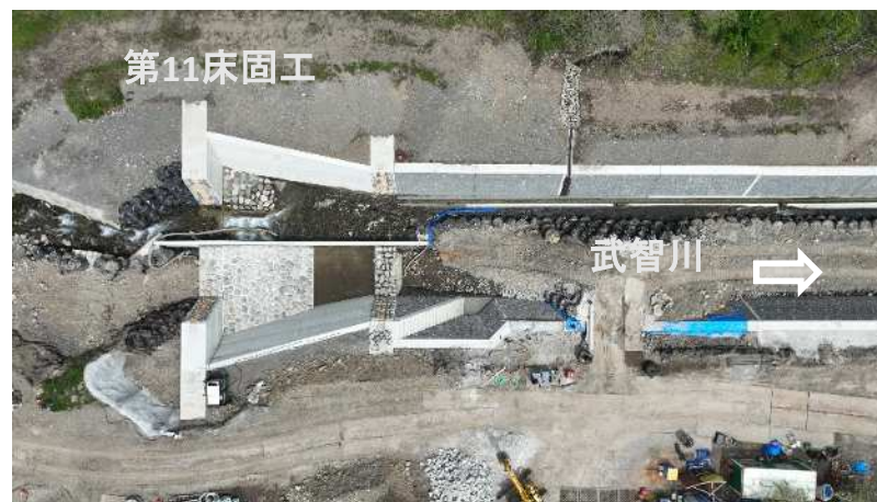
↑ 上空より施工箇所（第11床固工と流路護岸 ブロック積）を望む
