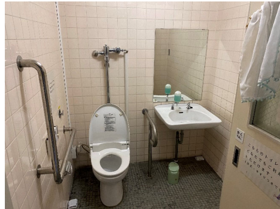
② 1階バリアフリートイレ
