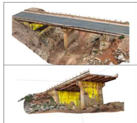
図-2 3D 損傷モデル
