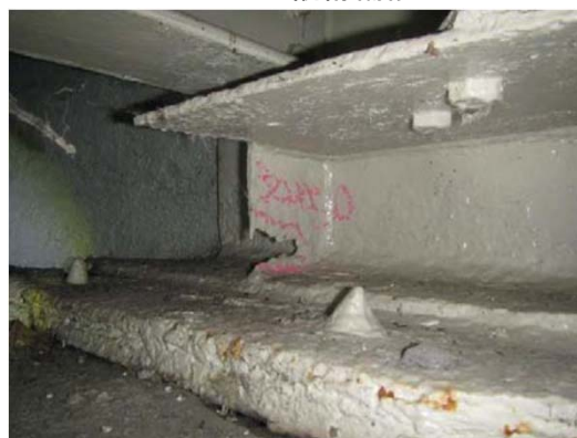
・主桁の腐食 <縦桁補修>
