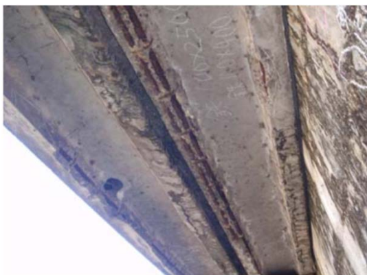
・主桁の剥離・鉄筋露出 <主桁補修>
