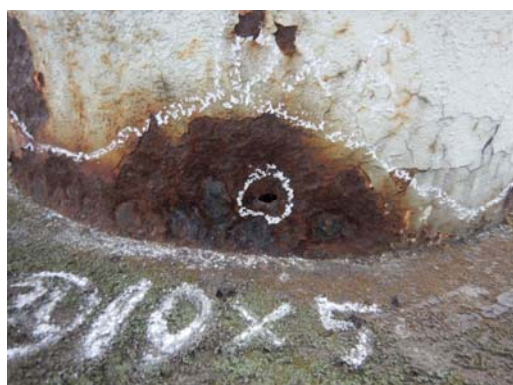
【要補修損傷箇所】
