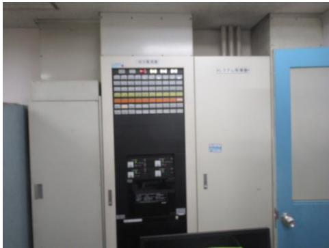
図1 事務庁舎棟（受信機）
