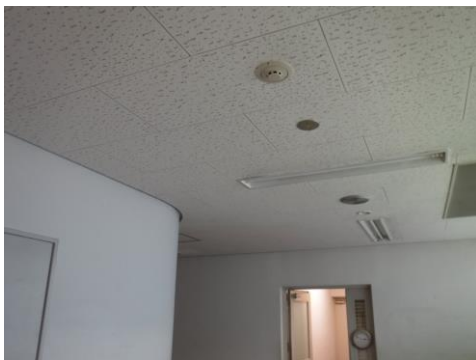
図3 事務庁舎棟（感知器）
