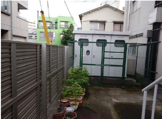
図1 庁舎 屋外キュービクル
