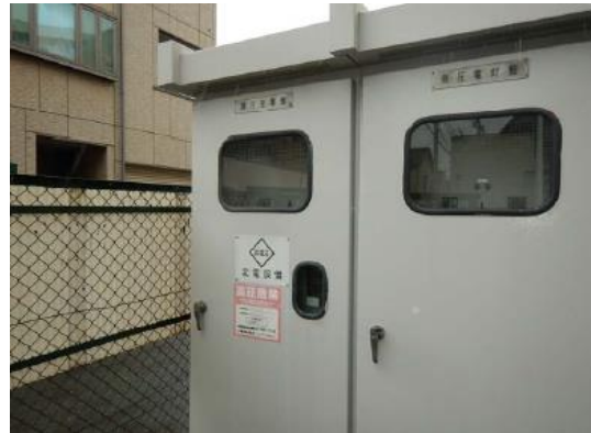
図2 庁舎 屋外キュービクル(高圧受電盤・低圧電灯盤)
