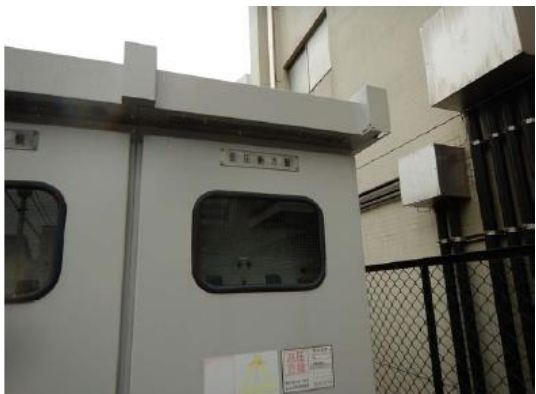
図3 庁舎 屋外キュービクル(低圧動力盤)
