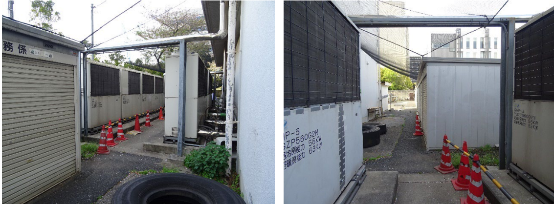
GHP 屋外機置き場
