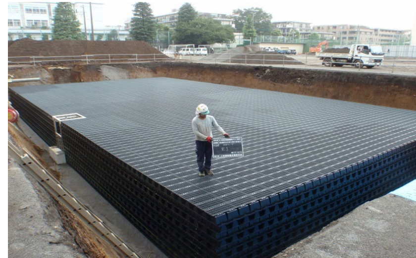
地下貯留(武蔵野市)
