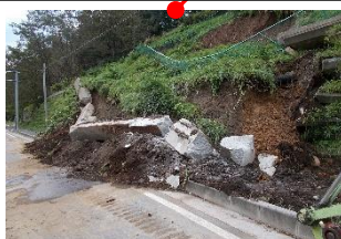
国道299号側面で土砂崩落 数日間通行止め(熊木町地内)
