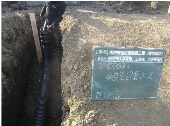
田んぼダム用水位調整管
