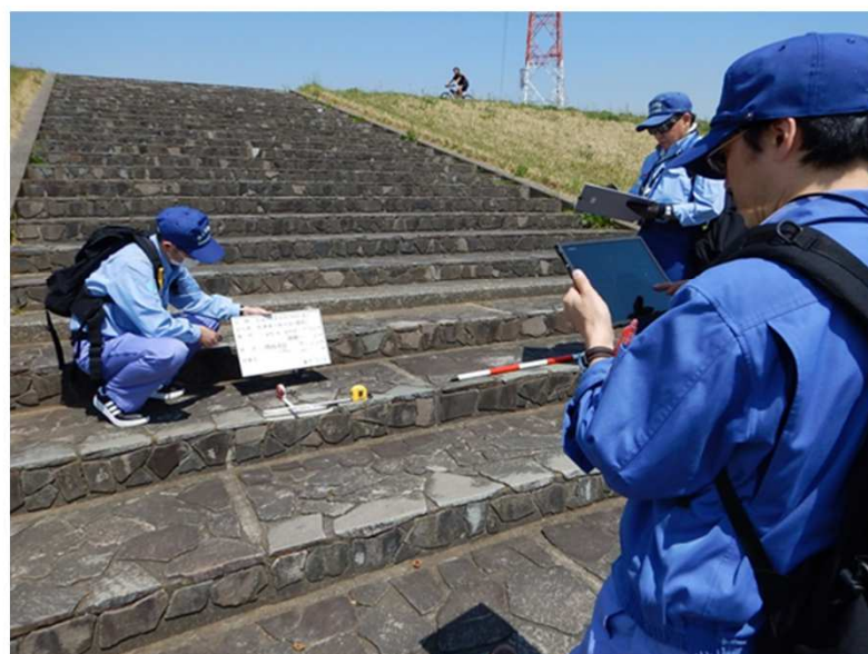
階段の破損状況を記録中
