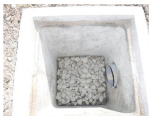
雨水貯留浸透枡整備事例(昭和町)
