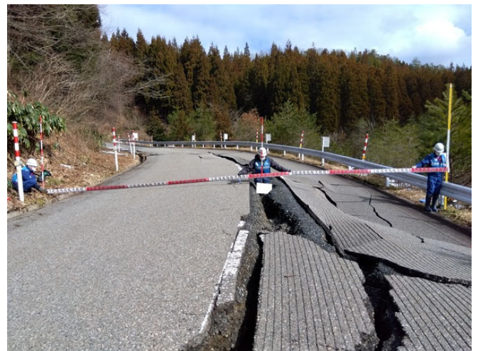
被災状況調査（亀裂の入った路面）【2月9日】
