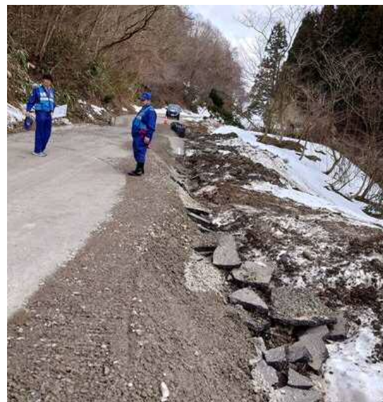
石川県能登町の町道の被災状況調査
