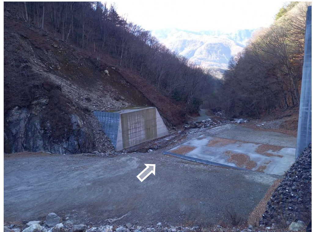
上流 右岸より本堰堤を望む（コンクリート堰堤工） （未着手）
