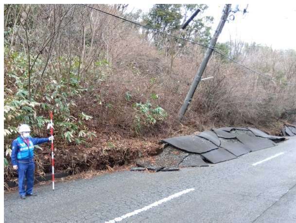
被災状況調査（道路法面の崩壊に伴い傾斜した電柱）【1月12日】
