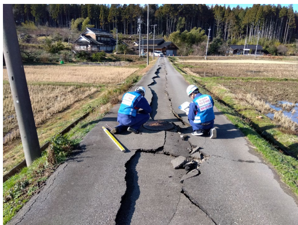
被災状況調査（陥没した道路）【1月11日】
