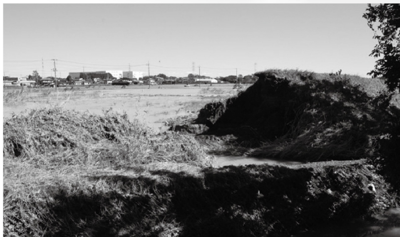
令和元年東日本台風の大雨で、決壊した都幾川の堤防。左側の農地や下流の民家が浸水被害を受けた(2019年10月13日午前、東松山市石橋地先。埼玉新聞撮影)
