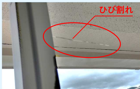
図3 熱割れの事例写真
