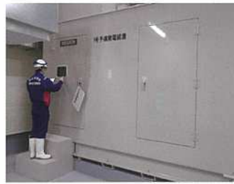
電気通信設備の点検 (予備発電機)
