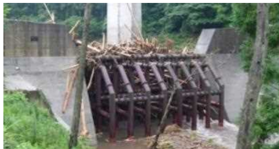
流木捕捉効果の高い砂防堰堤の設置
