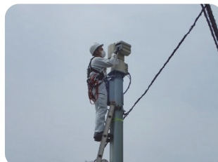
監視カメラ（CCTV）
