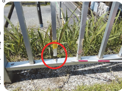
手すりの破損を確認
