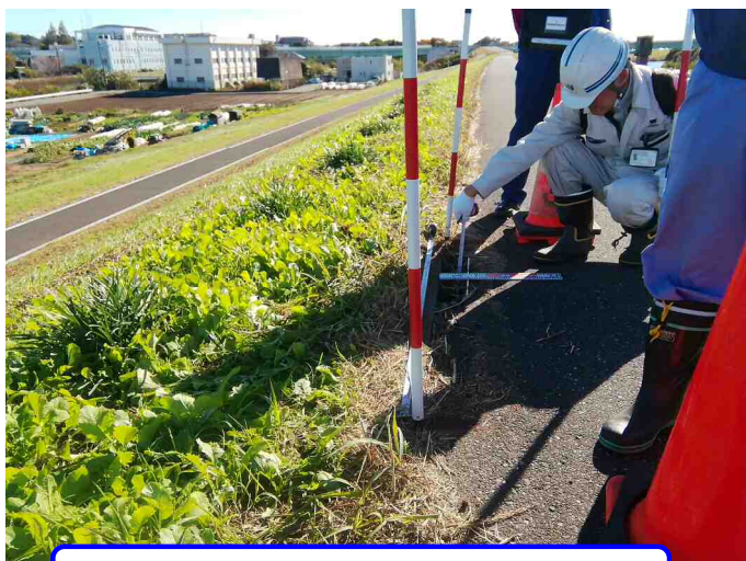
堤防天端舗装の損傷
