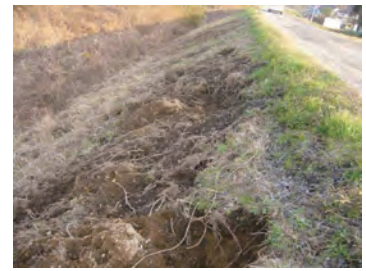
イノシシに荒らされた堤防
