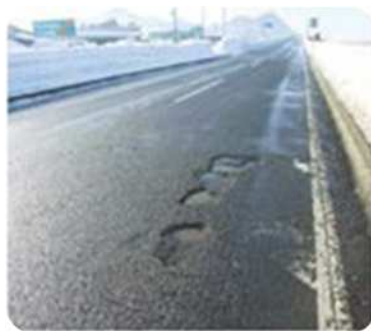
路面の穴ぼこ・ 段差
