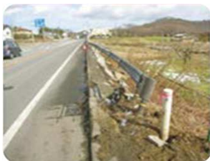
ガードレール・ 標識等の損傷
