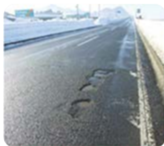
路面の穴ぼこ・ 段差
