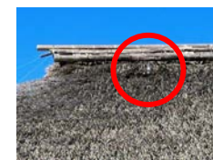
屋根のスプリンクラー
