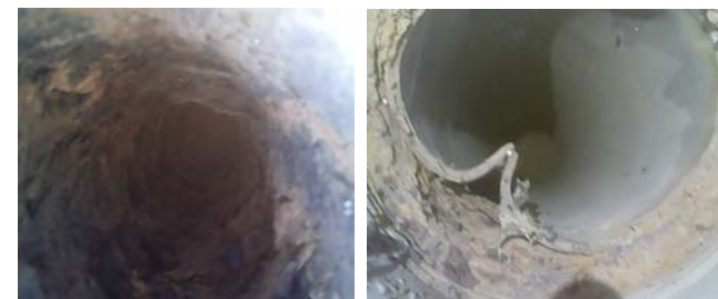
プール給水口の劣化状況
