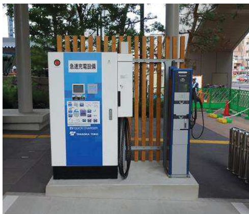
EV充電設備 出典:江東区HP
