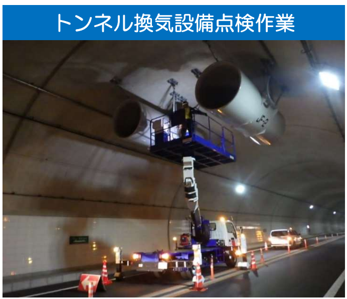
トンネル換気設備点検作業 高所作業車によるトンネル設備点検のイメージ写真 中部横断自動車道の点検時の写真です。
