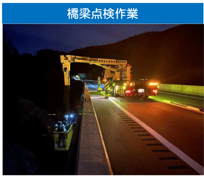
橋梁点検作業 橋梁点検車による点検のイメージ写真 中部横断自動車道の点検時の写真です。
