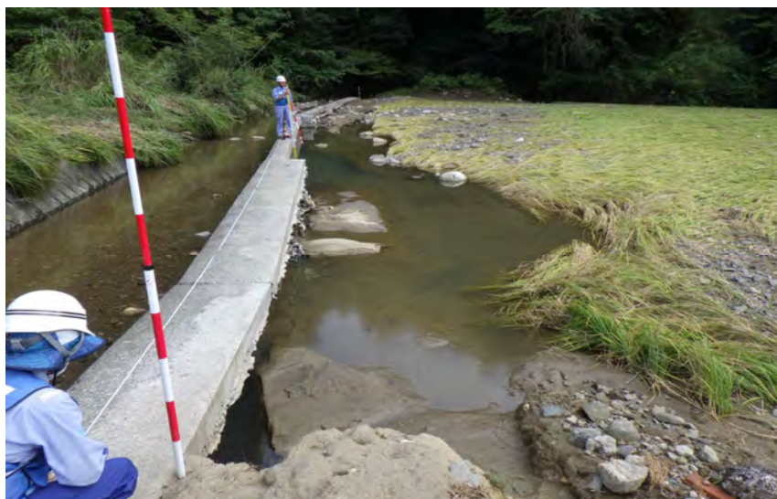
被災状況調査(茨城県北茨城市/板屋川)
