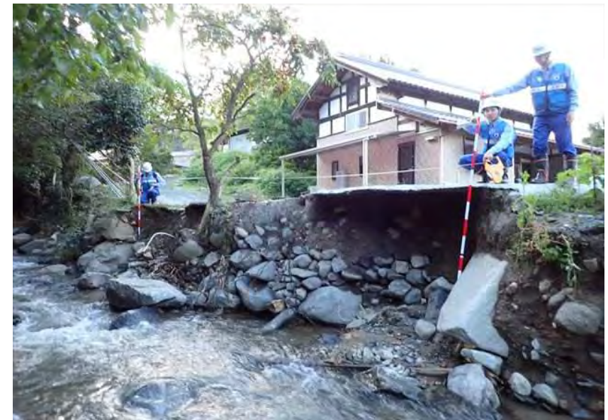
被災状況調査(茨城県北茨城市/内野川)
