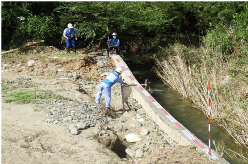
被災状況調査(茨城県北茨城市/小木板谷川)
