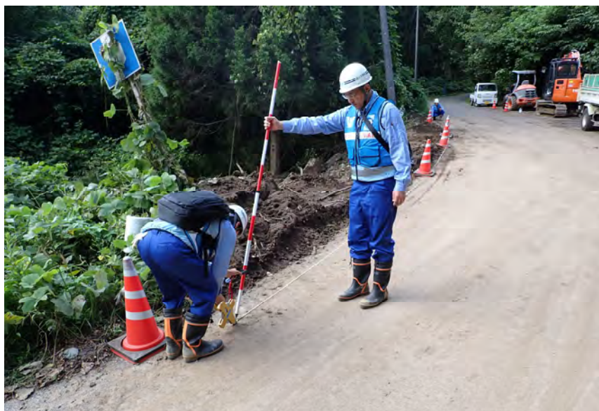
被災状況調査(日立市/市道10069号線)
