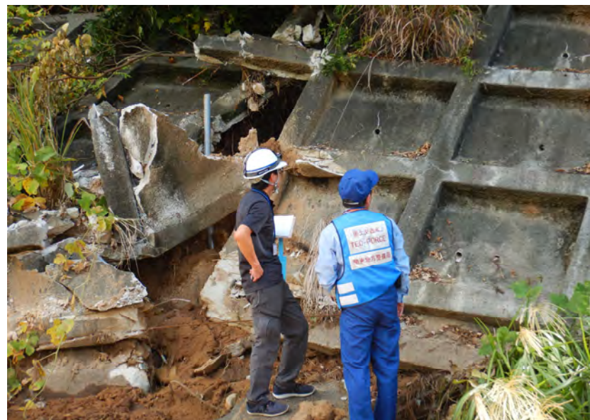
被災状況調査(北茨城市中郷町地先)
