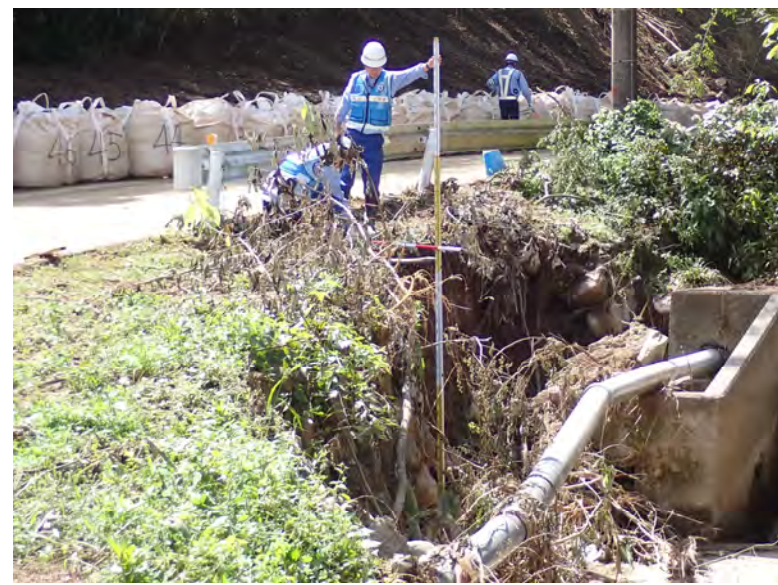
被災状況調査(日立市/市道10074号線)
