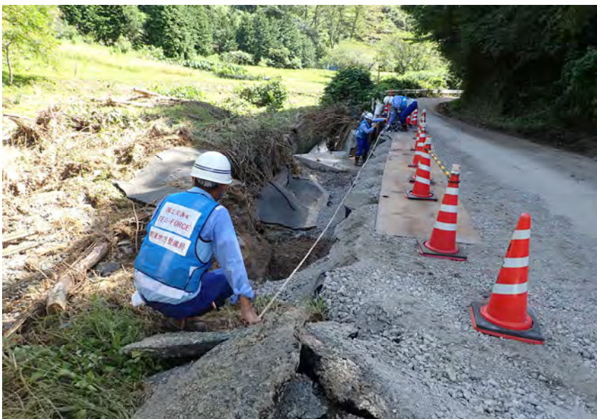
被災状況調査(日立市/市道10069号線)
