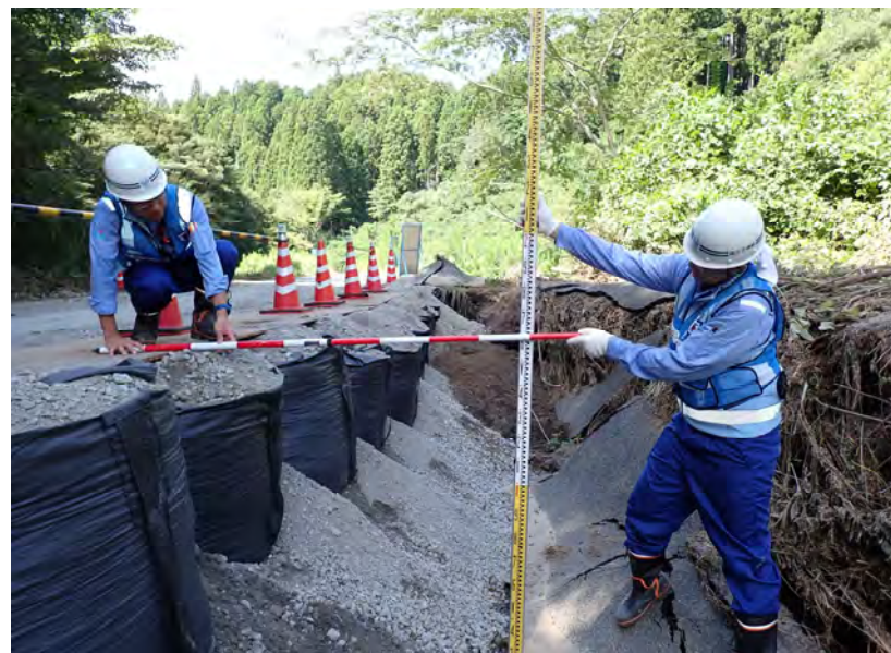
被災状況調査(日立市/市道10069号線)
