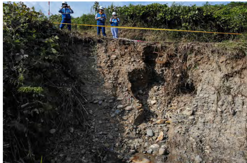
被災状況調査(茨城県北茨城市/ニツ島川) ドローンにて撮影
