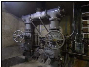
■道路排水ポンプ [R1完成箇所]
